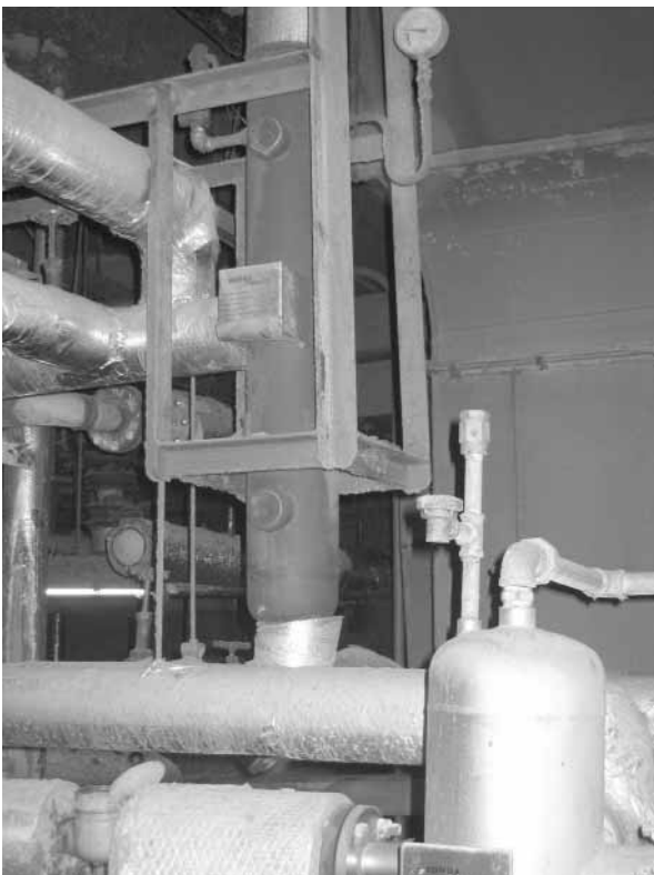
개선 후 후래쉬 베셀 설치 모습
