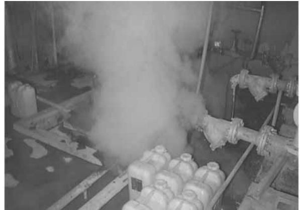
기존설비 - 급수탱크 재증발증기 벤트 모습
