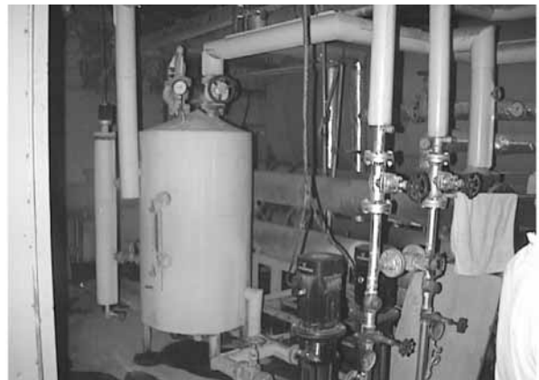
기존설비 - 수위제어방식의 통합 후래쉬탱크
