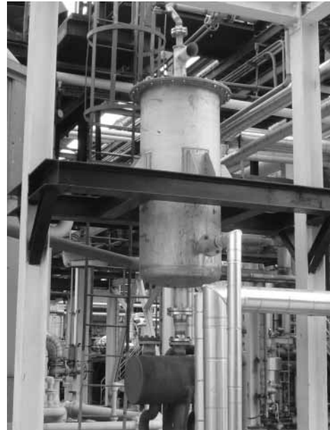
그림 6. S사 터빈 Leak-Off 스팀 회수를 위한 회수장치 설치 후 모습
