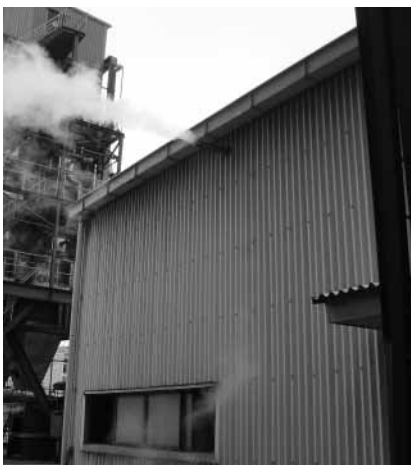
그림 5. S사 터빈 Leak-Off 스팀 회수를 위한 회수장치 설치 전 모습
