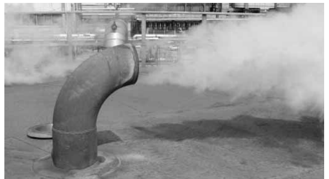
그림 2. S사 응축수탱크 상부 회수장치 설치 전 모습
