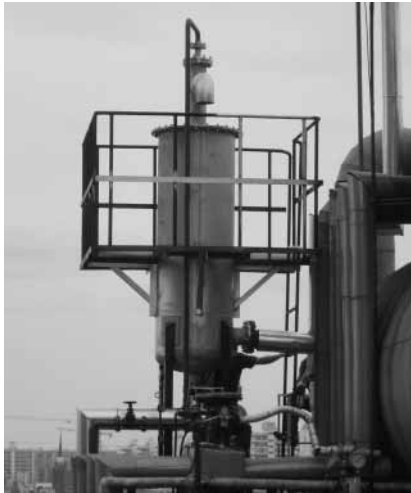
그림 4. I사 Deaerator Vent Steam 회수장치 설치 후 모습
