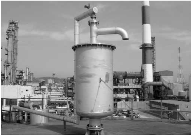
그림 3. S사 응축수탱크 상부 회수장치 설치 후 모습
