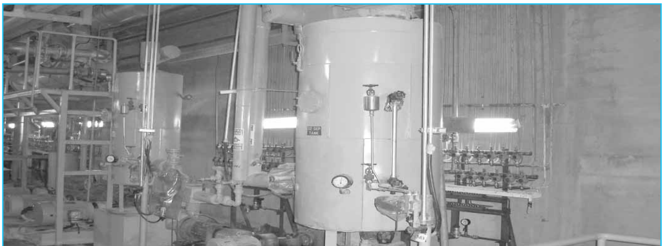
그림 3. 후래쉬 베셀 및 진공탱크 설치 모습(P 제지공장)
