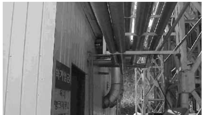
바이패스 밸브를 잠근 후 응축수 탱크의 벤트 상태
