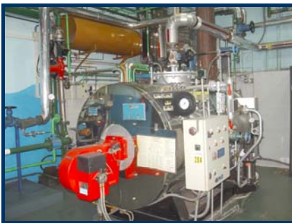
Caldera de vapor
